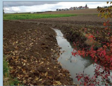
Le reméandrage de la Souffel à Stutzheim-Offenheim. Un deuxième programme de renaturation des cours d'eau du bassin de la Souffel est prévu cette année. Photo DNA/E.K.
