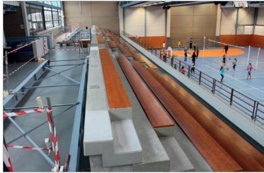
Au gymnase du Kochersberg, l'agrandissement des gradins fait partie des travaux en cours.
