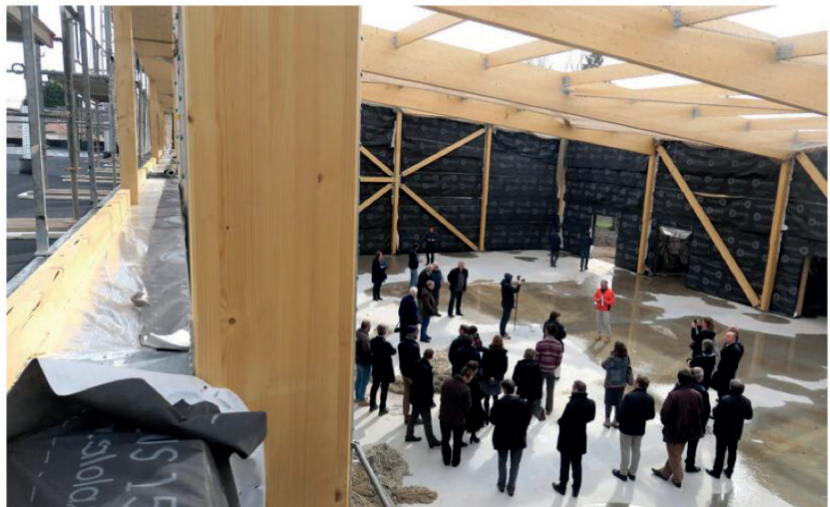
Les financeurs et acteurs du projet sont venus constater le bon avancement du chantier.
